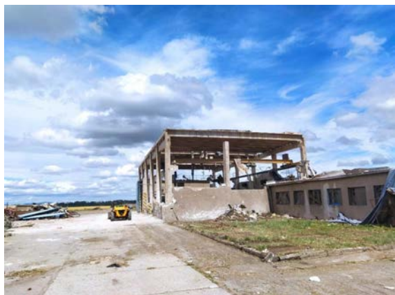
Obr. 19 Poškození betonové skeletové konstrukce
