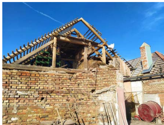
Obr. 4 Poškozený štít dvorního stavení
