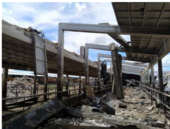
Obr. 20 Poškození štítového zdiva administrativní budovy
