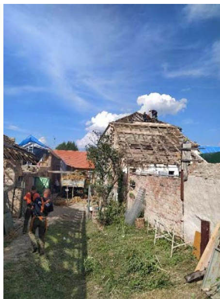
Obr. 12 Dům s dlouhodobě narušeným krovem a zdivem
