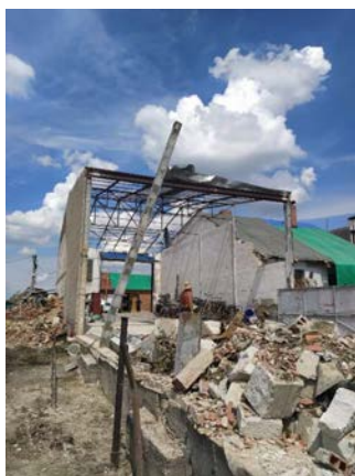
Obr. 5 Poškozená ocelová zemědělská hala
