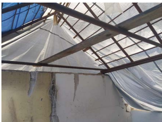
Obr. 7 Typické vypadnutí štítu rodinného domu s ocelovým krovem
