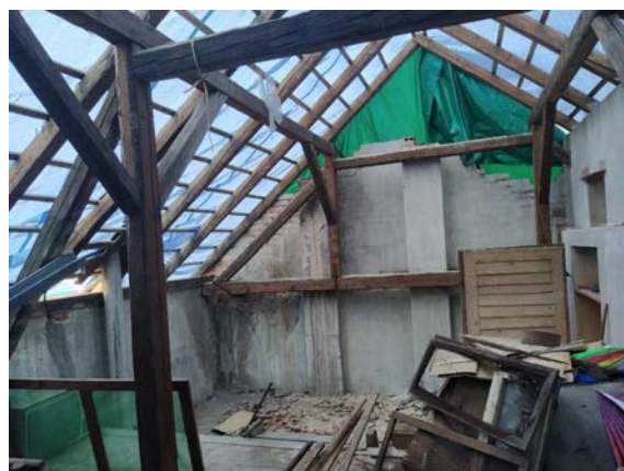
Obr. 8 Pohled do krovu, typické porušení štítu
