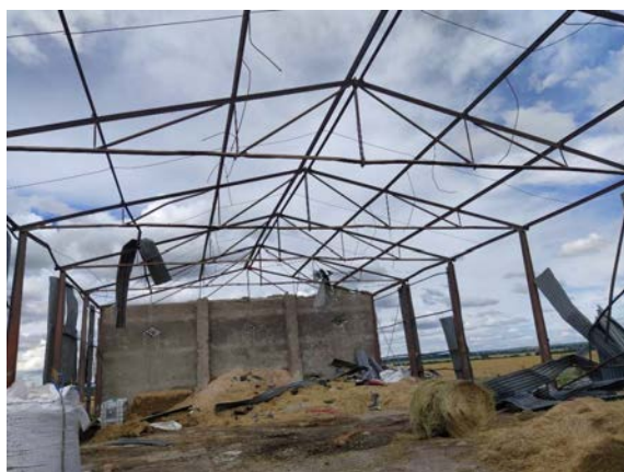
Obr. 17 Poškození ocelové konstrukce seníku
