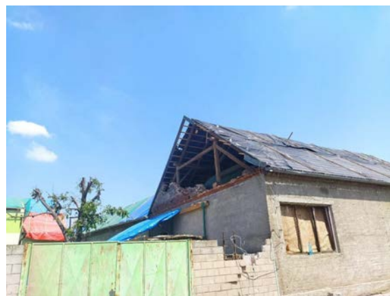
Obr. 6 Typické vypadnutí štítu rodinného domu
