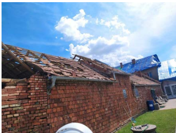
Obr. 3 Poškozená krytina a stěny dvorního stavení
