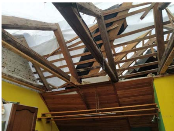
Obr. 9 Destrukce podkrovní spadlým štítem sousedního domu
