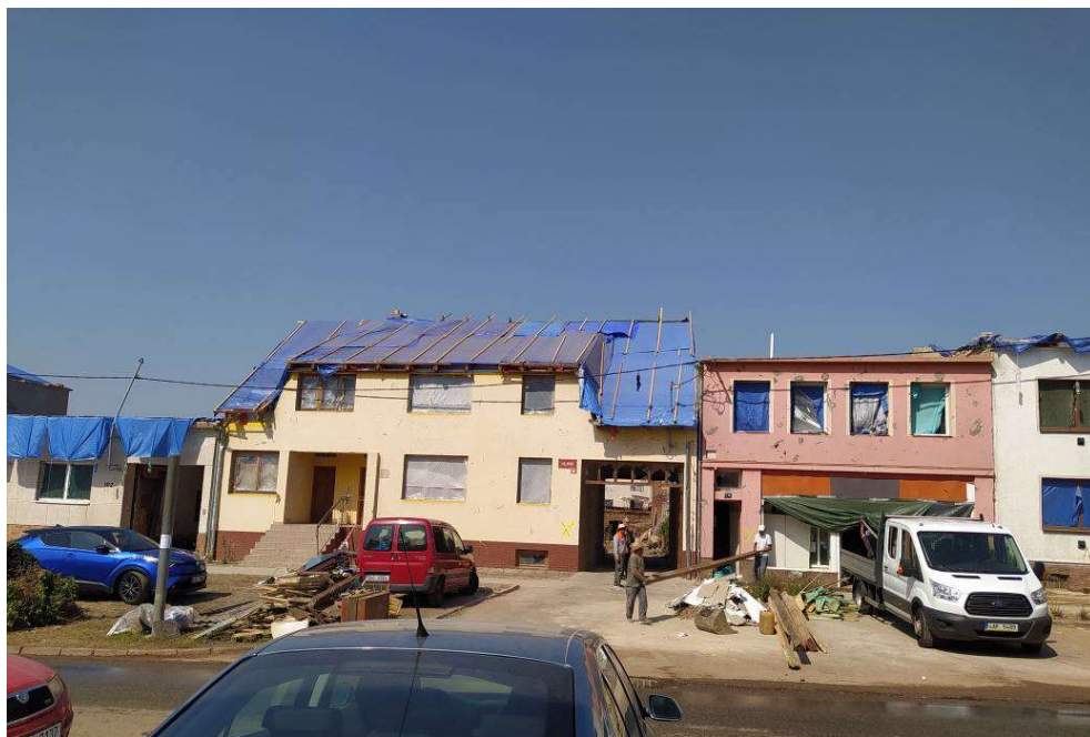
Obr. 2 Řadová zástavba v Moravské Nové Vsi, rodinné domy po zásahu tornádem
