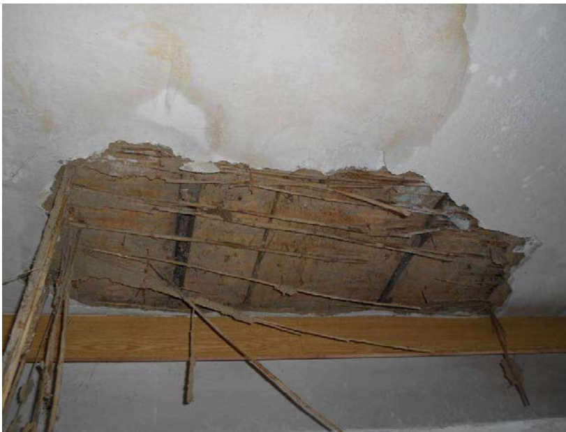
Obr. 5 Rodinný dům v obci Nemitice po požáru – stropní konstrukce promáčená po zásahu hasičů přetížená zříceným zdivem podkroví
