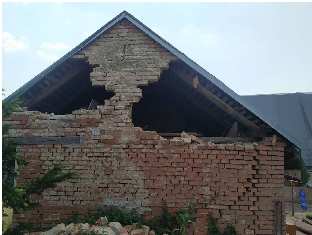
Obr. 3 Štít poničený sáním větru s ponechanou částí zdiva v okolí zesilujícího pilířku (foto: Ing. Koudelka, Ph.D.)
