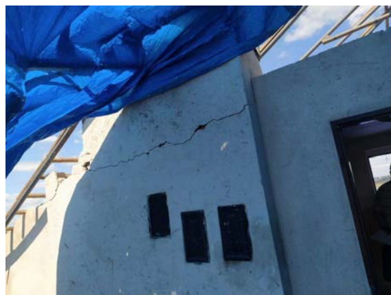
Obr. 10 Narušení komínového zdiva
