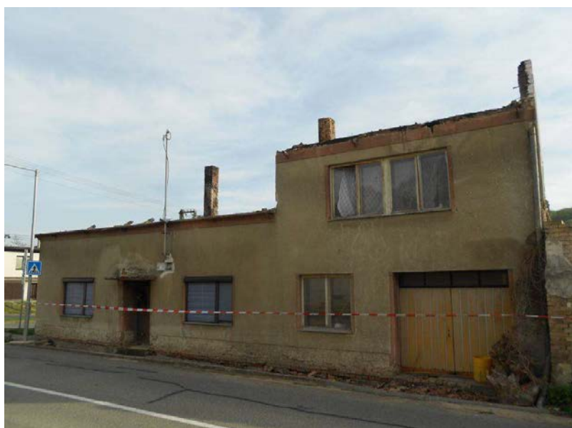
Obr. 3 Rodinný dům v obci Nemotice po požáru v podkroví a na půdě
