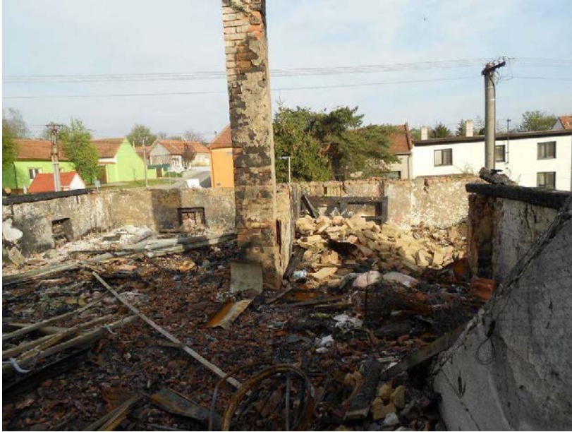
Obr. 4 Rodinný dům v obci Nemitice po požáru – zřícené části zdiva v podkroví
