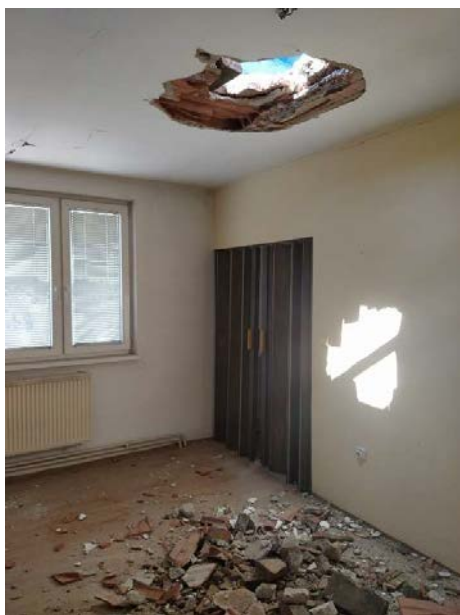
Obr. 11 Narušení hurdiskového stropu pádem komínového zdiva
