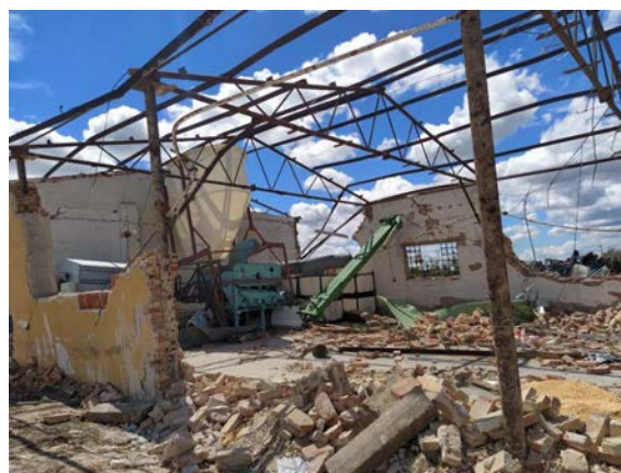
Obr. 18 Poškození vyzdívek a ocelové konstrukce
