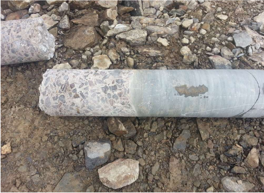
Obr. 1 Výrazně odlišná kvalita betonu v jádrovém odvrtu
