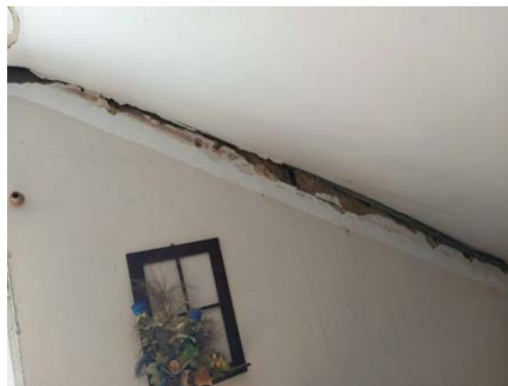
Obr. 14 Posunutí krovu a podhledů v podkroví
