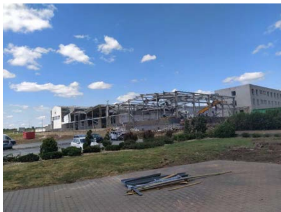
Obr. 15 Poškození areálu v Lužici
