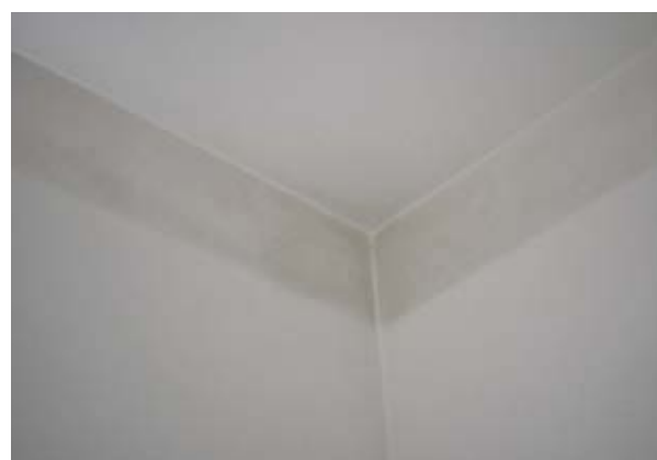
Obr. 5 Projev kondenzace na povrchu železobetonového věnce
