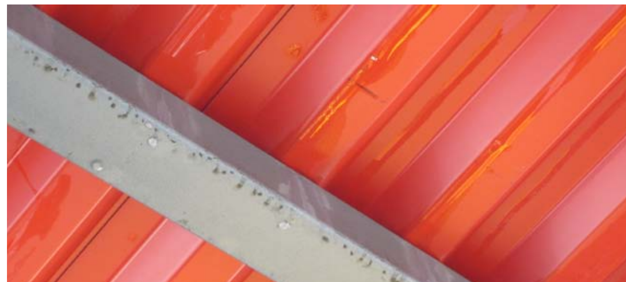
Obr. 3 Kondenzace vodní páry na dolním líci ocelového stropu, který se nachází nad výstupním schodištěm zastávky tramvaje
