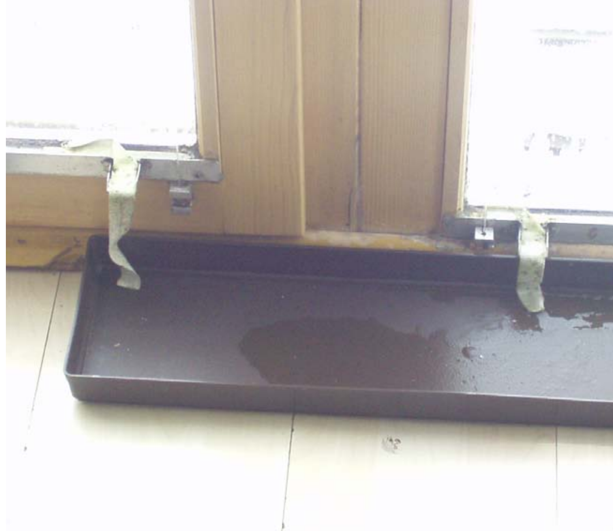
Jak uživatelé řeší odvod kondenzace z oken
