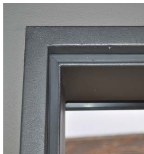
Obr. 7 Kondenzace vodní páry na vnitřním povrchu zárubně
