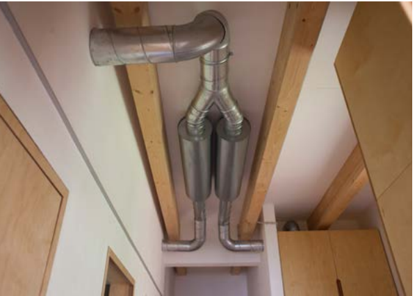
Vzduchotechnika je v interiéru přiznaná.
